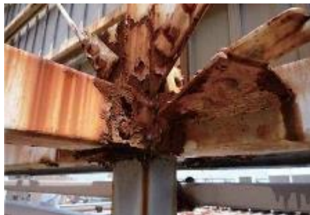
老朽化により腐食した屋上広告物の骨組み
