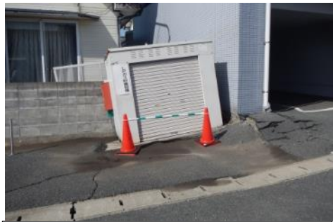
液状化による建物の傾斜
