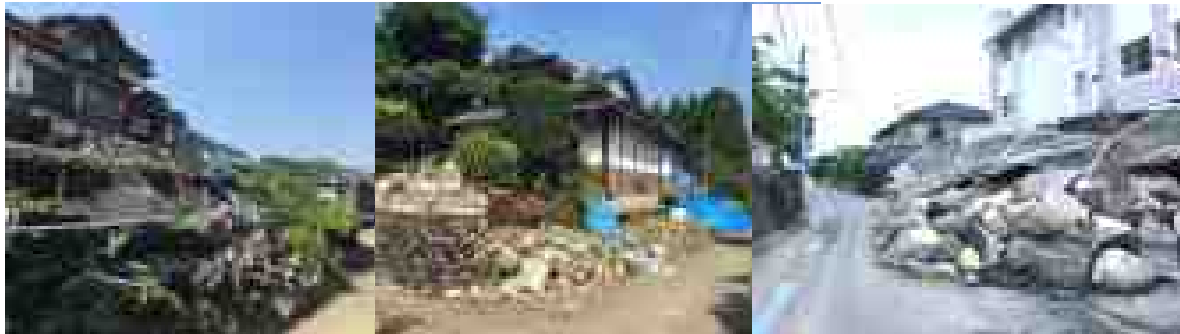
宅地被害(擁壁の倒壊)
