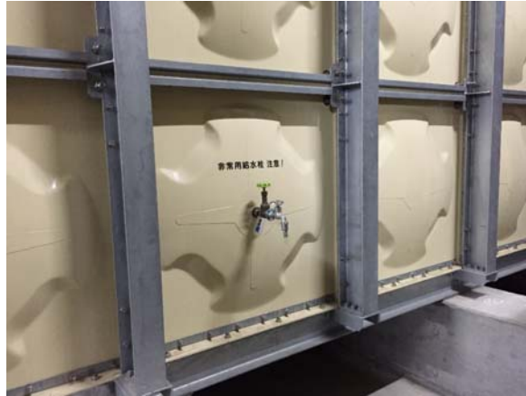
非常用給水栓
