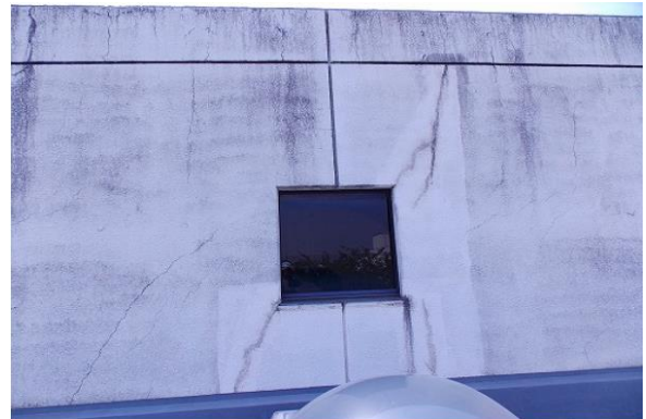
図 2-8 外壁仕上の劣化事例
