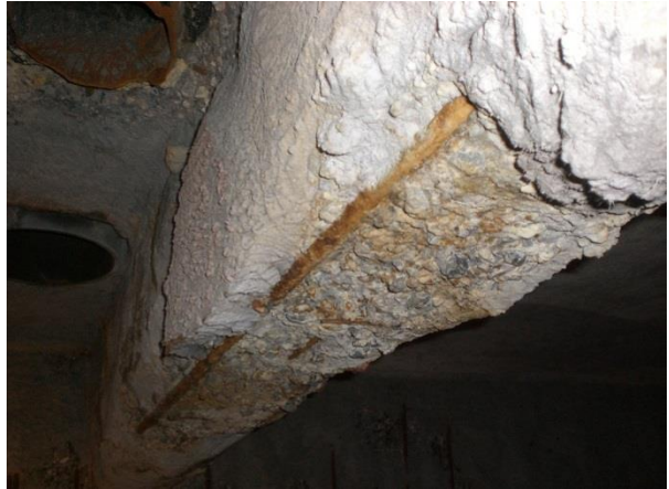
図 2-2 化学的侵食事例(濃縮汚泥受槽)
