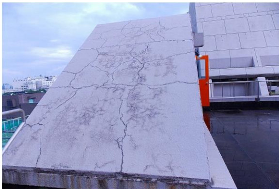
図 2-7 屋上防水の劣化事例
