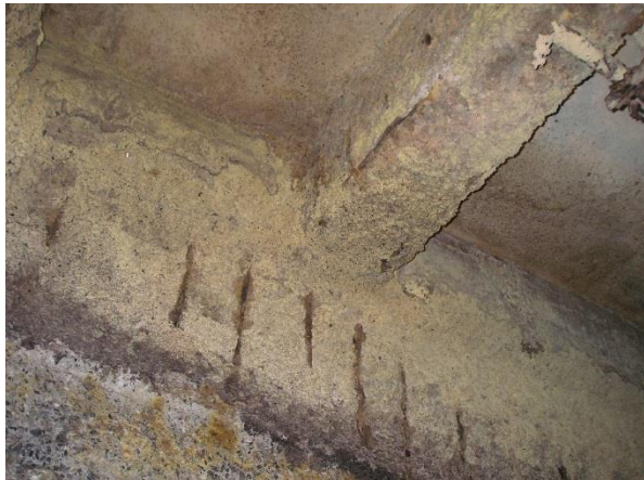
図 2-1 化学的侵食事例(返流水槽)
