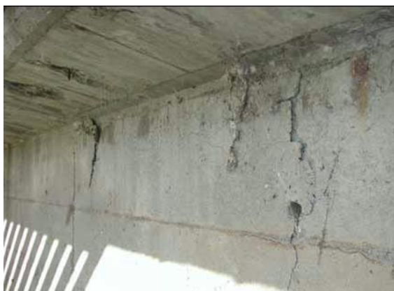
図 2-3 中性化事例(反応タンク)
