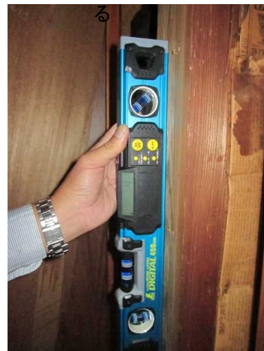
写真9 柱の傾斜が 1/20 以上の箇所がある
