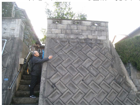
写真 11 道路側に面した間知ブロック積み部分で目地が広がっている箇所が見られる
