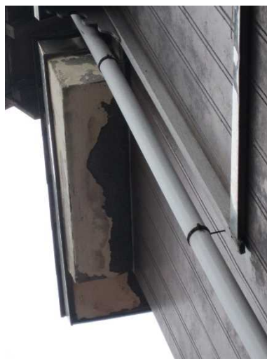
写真8 底下のモルタル剥離が見られる
