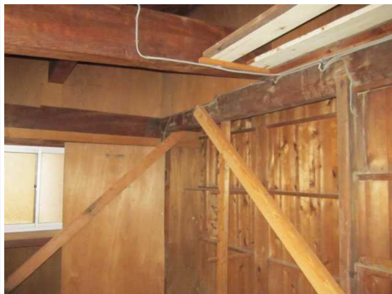
写真7 建物の外周部分が傾いているため、隣接家屋へ倒壊防止措置を実施している
