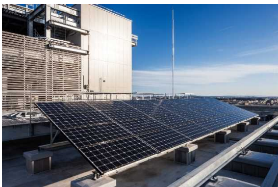
写真3 太陽光発電設備
