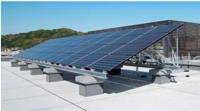
太陽光発電設備 <唐津港湾合同庁舎>
