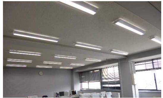
写真1 LED照明器具
