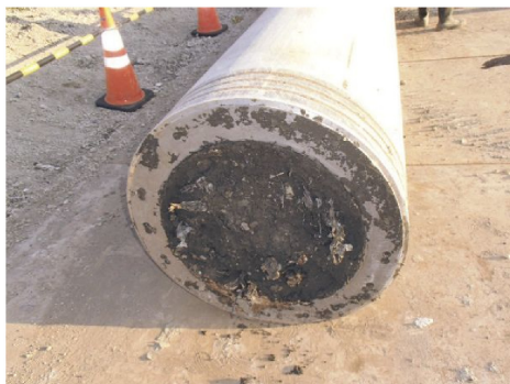
付録写真-2.5 杭内部の閉塞状態
