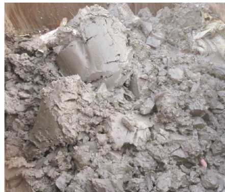
付録写真-2.7 遮水層からの掘削土砂。廃棄物が混じっている。
