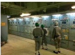
発電状況を監視する配電盤
