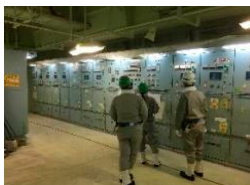
発電状況を監視する配電盤
