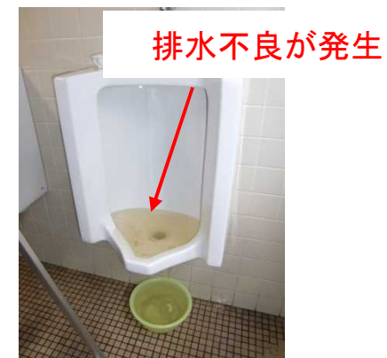
機械設備：排水設備の経年劣化により、排水不良が発生している
