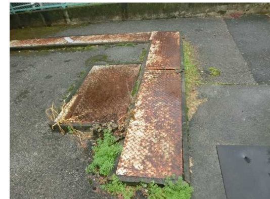
電気設備：屋外配管側溝蓋に経年劣化による錆が発生している
