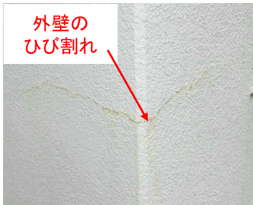
外壁：躯体にひび割れが発生している
