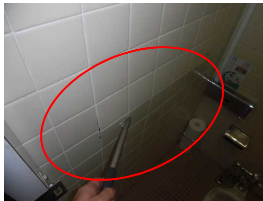
内壁：経年劣化によりタイルのひび割れや浮きが見られる
