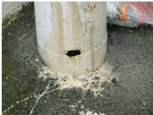
屋上：腐食により鋼管(排水管)に穴があき漏水が発生している
