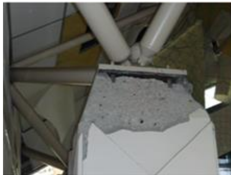
(b) RCS接合部の被害
