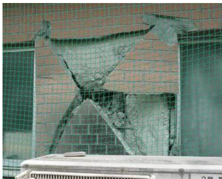
(a) 非耐力壁の被害
