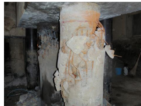
(c) 既成杭の被害
