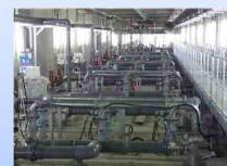
実証施設 (高知市下知水再生センター)
