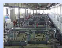
実証施設 (高知市下知水再生センター)
