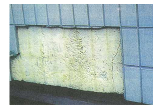
■タイルの「著しい剥がれ」 出典：資料①
