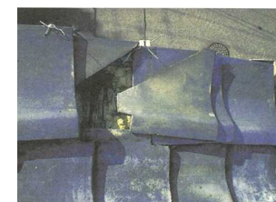
■ 瓦の「著しい割れ」を伴う「著しいずれ」 出典: 資料①
