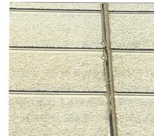
■「シーリング材の接着破壊」 出典: 資料①
