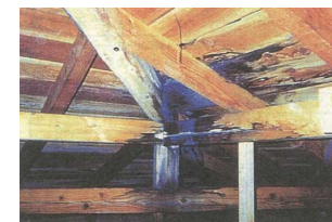
■ 小屋裏の雨漏り部分の腐朽 出典: 資料①
