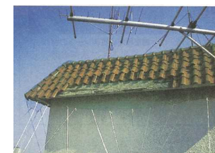
■ 瓦の「著しい剥がれ」 出典: 資料①
