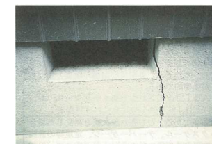
■基礎の「著しいひび割れ」 出典：資料①
