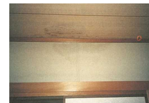
■天井の「漏水等の跡」 出典：資料①
