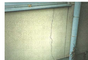
■モルタルの「著しいひび割れ」出典：資料①
