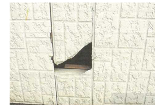
■「仕上げ材の著しい欠損」 （窯業系サイディング） 出典：資料①
