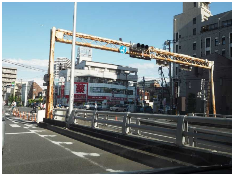
錆びが目立ち景観に配慮されていない門型標識柱
