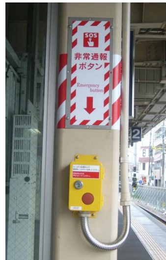
非常停止押しボタン
