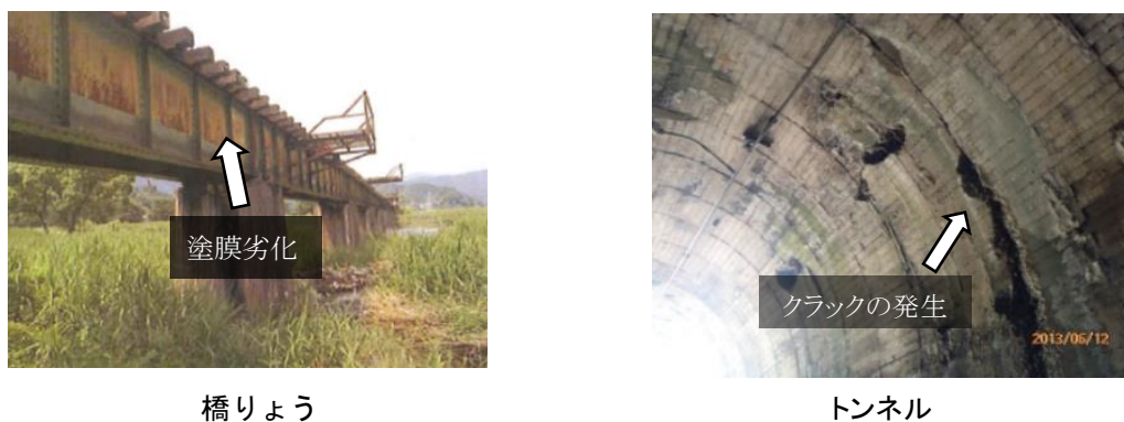
図4：老朽化が進んでいる施設の例
