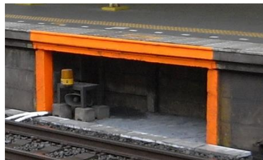
ホーム下の待避スペース
