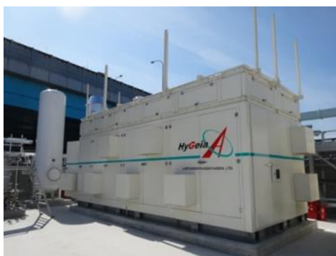
下水汚泥からの水素製造装置 (福岡市)
