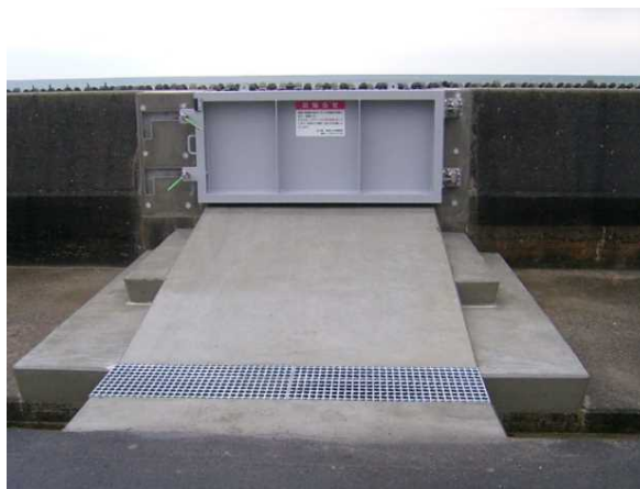
陸閘(鋼製ゲート)
