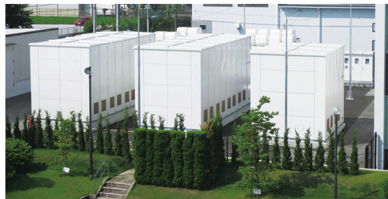
【設置例】 マルホ彦根工場殿 3000kWシステム
