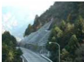
&lt;のり面防災対策&gt;
