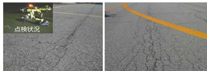
老朽化した施設 (滑走路にできたクラック)
