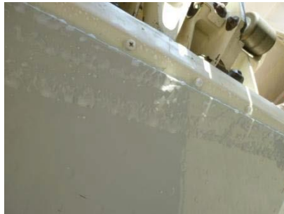
図 3-4 貨物室ドア下部縁沿い着氷事例
