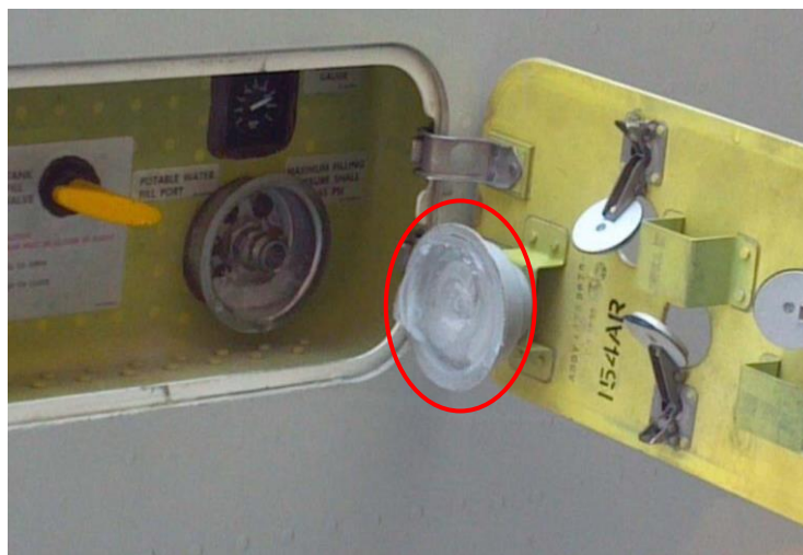
図 3-2 Fill Fitting 着氷事例 (POTABLE WATER SERVICE パネル)
