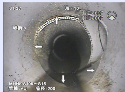
破損A(管路)
