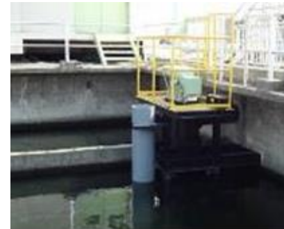
北九州市 日明浄化センター
