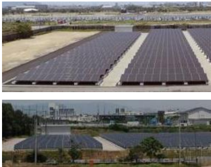
兵庫県 揖保川浄化センター(上) 武庫川下流浄化センター(下)
