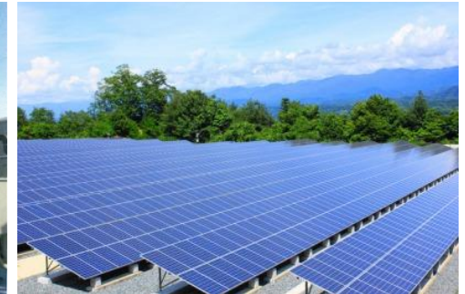
場内敷地を活用する太陽光発電
