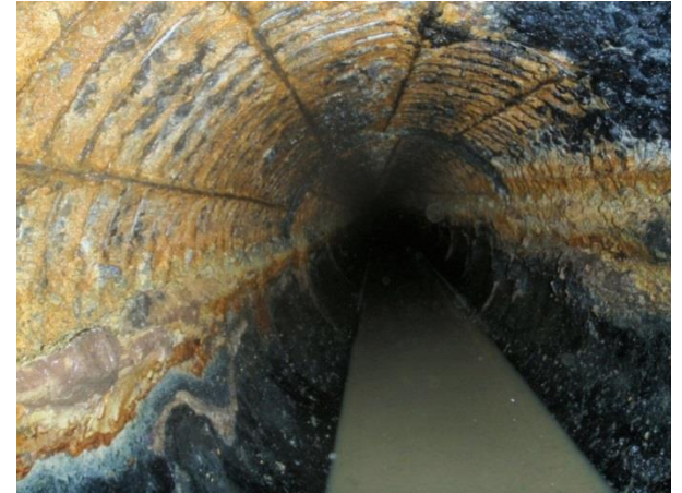
コンクリート管の腐食例
