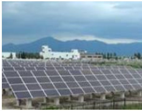
山形県 山形浄化センター
