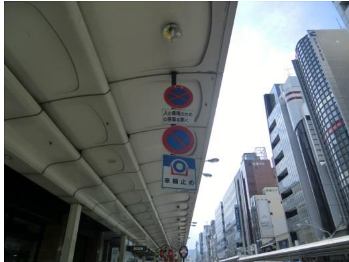
写真13 整備前の規制標識
