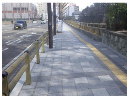
(道路) 横断防止柵及び転落防止柵 (和歌山県和歌山市) 和歌山停車場線
