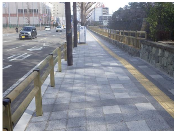
横断防止柵及び転落防止柵 和歌山停車場線 (和歌山県和歌山市)
