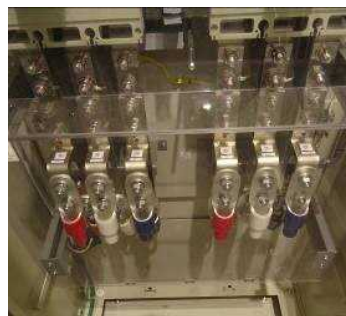
移動電源車の接続口
