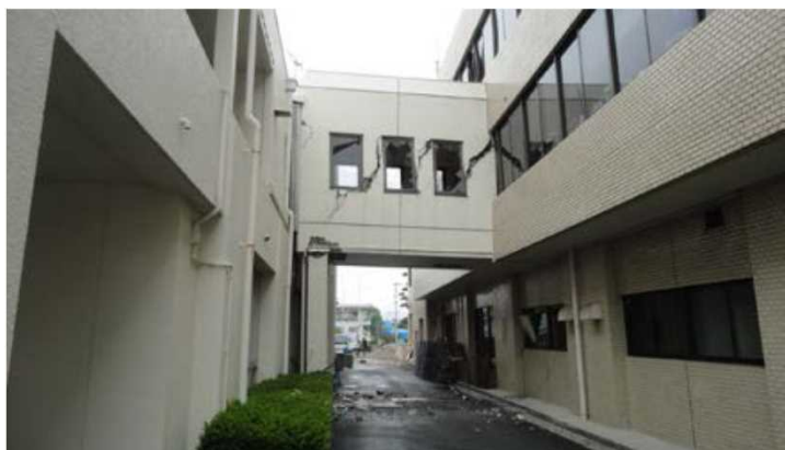
庁舎における構造部材の損傷
