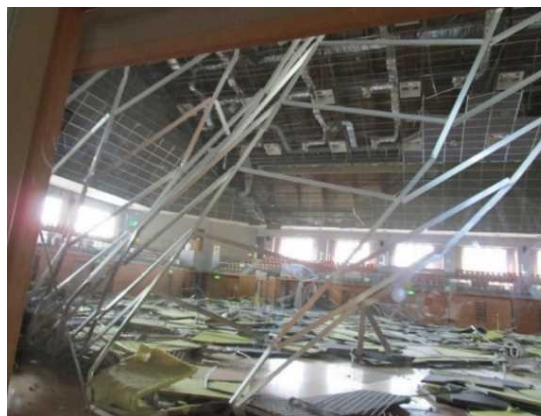
体育館における天井の損傷
