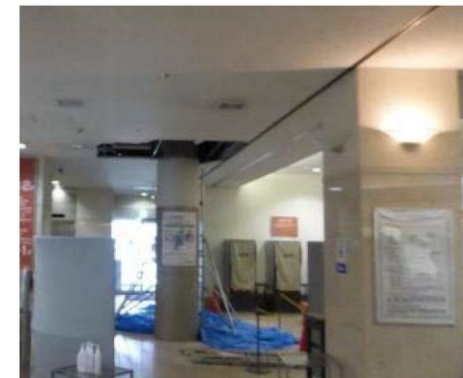
病院における天井の落下
