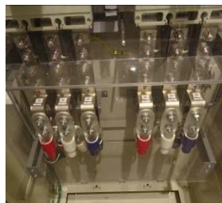
移動電源車の接続口
