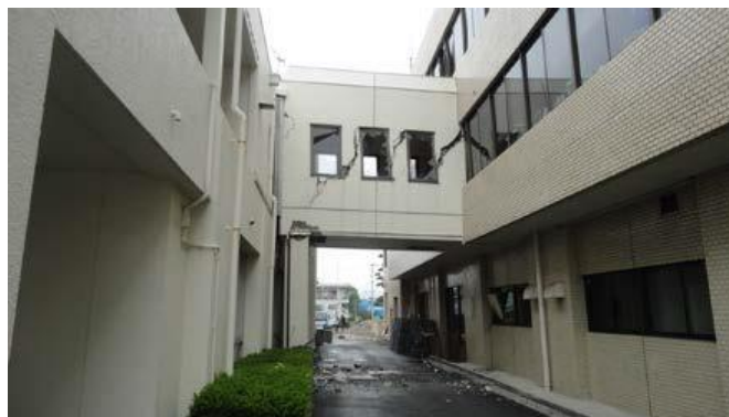
庁舎における渡り廊下の構造部材の損傷
