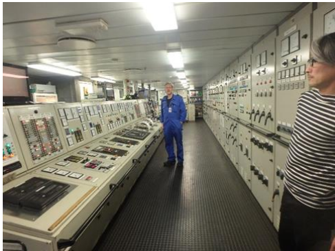
エンジンコントロールルーム
