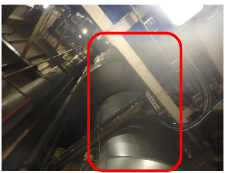
スクラバー本体 (ファンネル内を下から見た光景)
