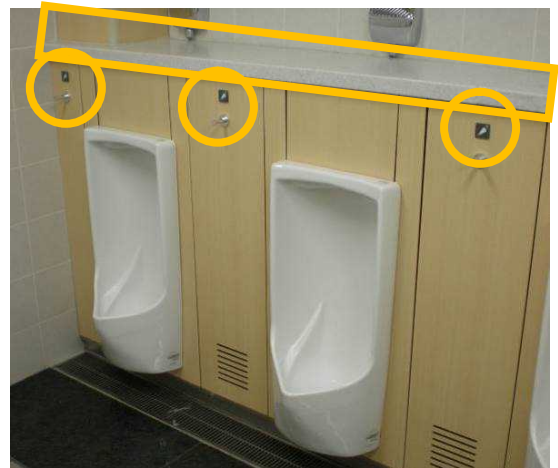
小便器の横に設置される例
