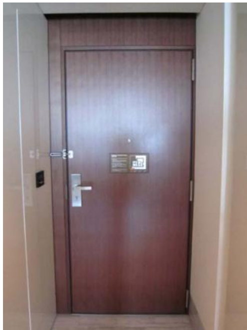
ユニバーサル客室出入口（室内側）
