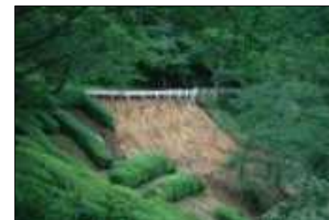
④ 野村ダム、路肩崩壊
