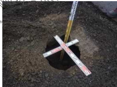
舗装下にφ60cm×深さ60cmの空洞
