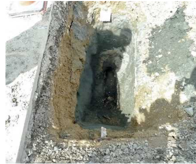
管渠上部が開孔
