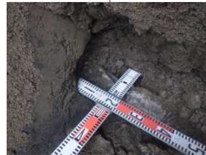
管渠（車道側）に長さ30cm×幅10cmの開孔
