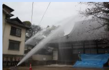
常称寺に設置した防災設備
