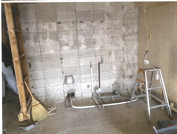
キッチン廻り配管状況
