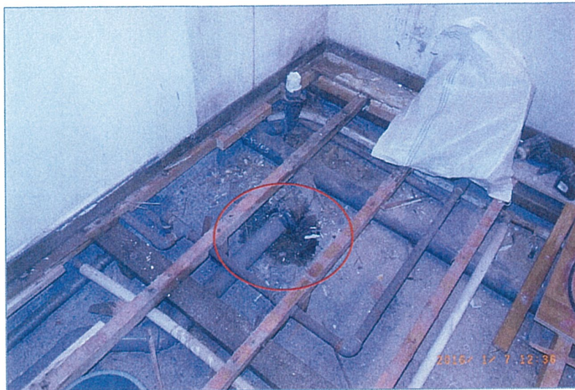
洗面所 配管 漏水 (607 号室)
