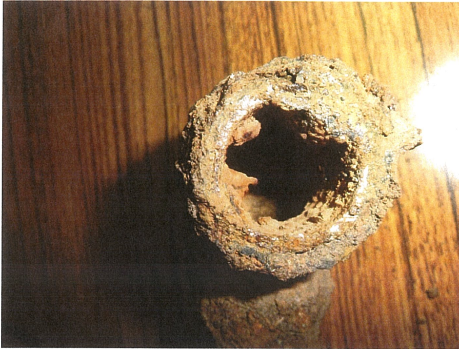
給水管エルボ錆
