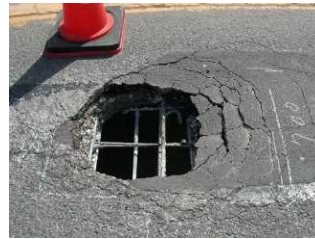
【道路が損傷した例】
