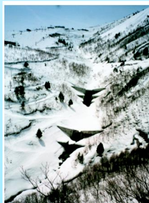
雪崩の発生危険箇所をもつ砂防堰堤(長野県白馬村)
