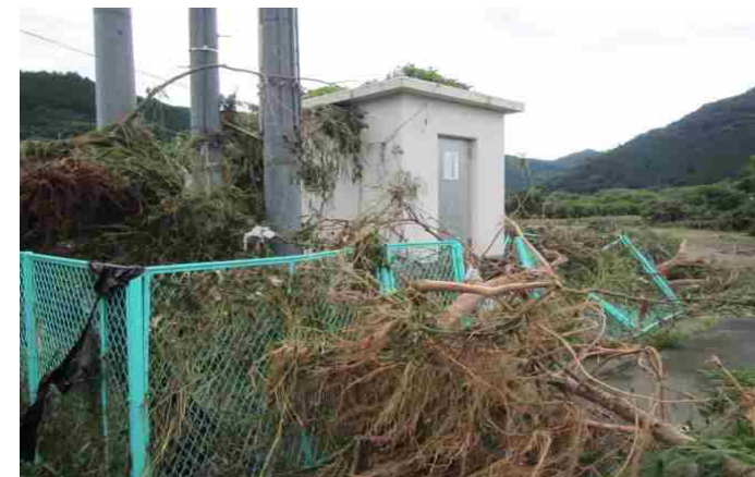
放流警報設備の浸水後の状況
