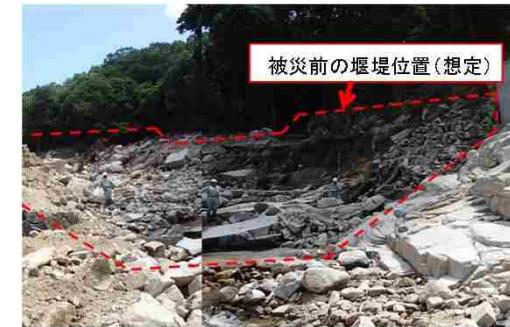
石積砂防堰堤の被災例 (広島県安芸郡坂町 天地川)
