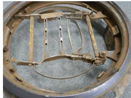
転落防止梯子の変形
