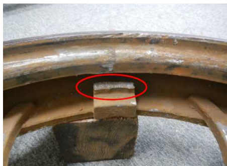
受枠の蝶番座の破損
