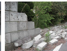
地震により石塀が倒壊
