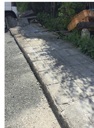
地震によりブロック塀が倒壊
