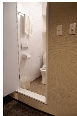
浴室等の出入口の段差
