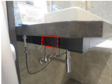
洗面台下のフタ付きコンセント
