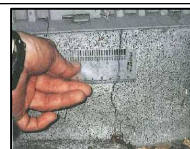
基礎のひび割れ幅の計測
