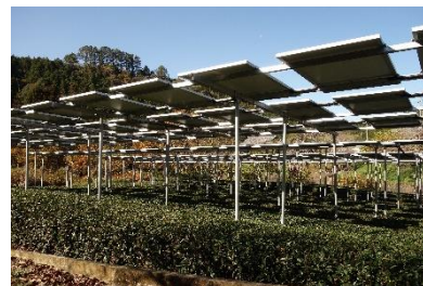
太陽光パネルとその支柱
