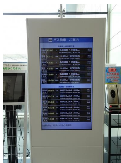
病院内に設置されたバス車両接近表示システム
