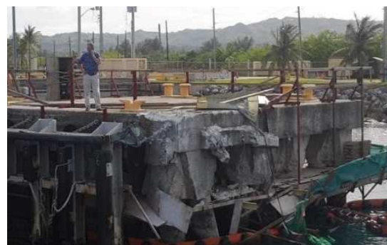
● 栈橋の損傷状況
