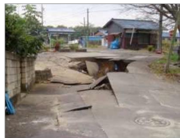
亜炭鉱廃坑の崩落による陥没被害
