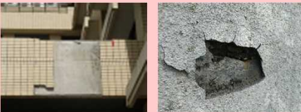
外壁タイルの一部が階下へ落下
