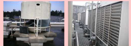
壊れかけた冷却塔
